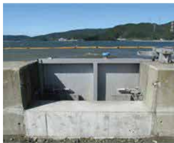
津波対策隔壁扉パッキン
